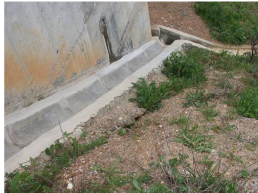
Caleiras de drenagem
