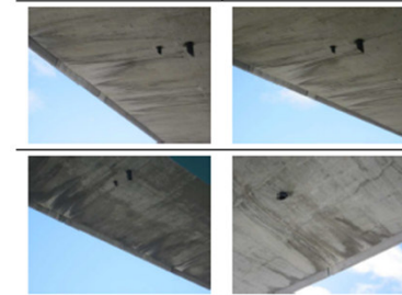
Figura 6 – Escorência de água com eflorescência na consola do tabuleiro
