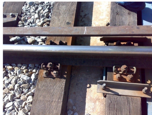
Fixações de via
