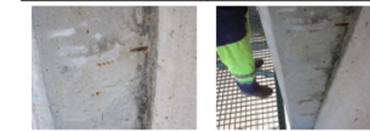
Figura 7 – Exposição de armadura e corrosão, por falta de recobrimento nos pilares
