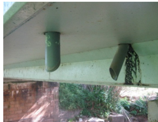
Coletores/Tubos de queda
