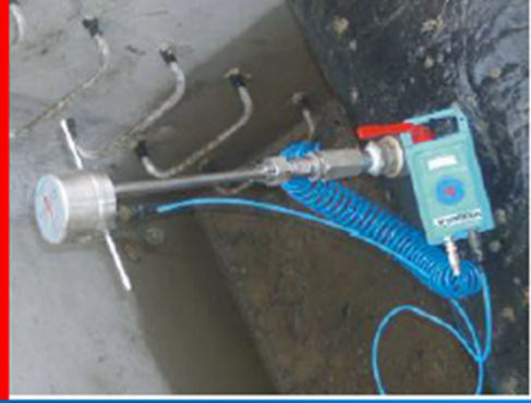
Datalogger ligado a medidor de caudal intrusivo
