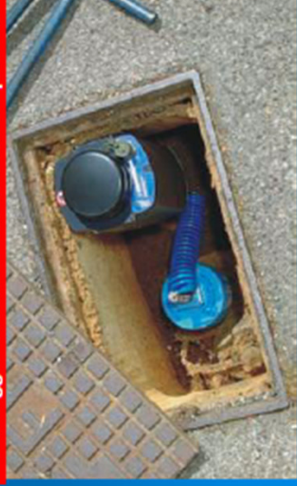
Datalogger instalado em B.I. a medir pressão
